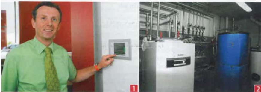
1 Oliver Schultheiß am Touchscreen für die Steuerung der Hauselektrik 2 Wärmepumpentechnologie: Die Erdwärme dafür wird über 8 Bohrungen aus 90 Metern Tiefe gezapft
